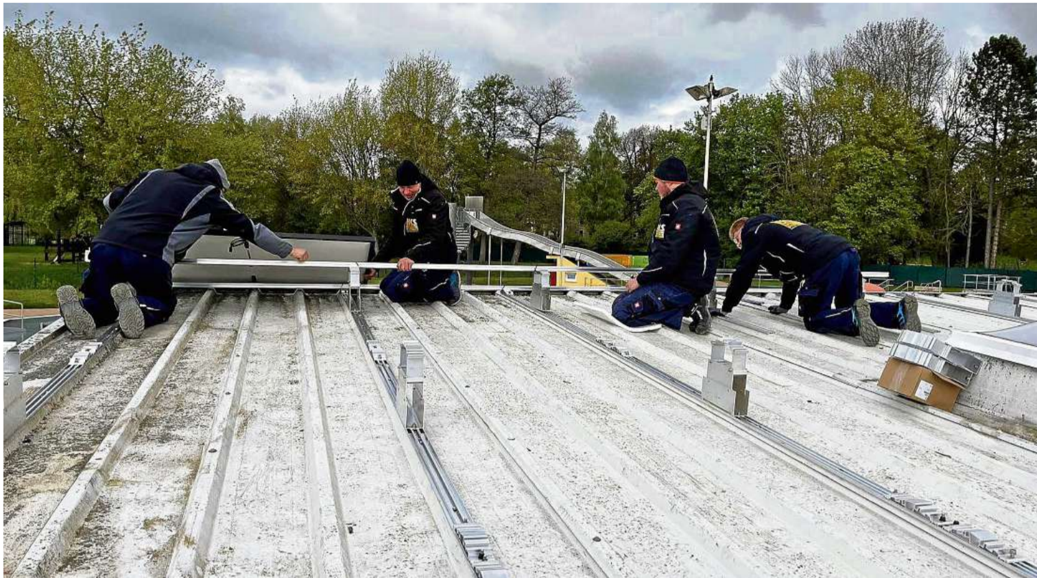
Arbeiter erledigen hier Vorbereitungen für die Photovoltaikanlage auf dem WC-Trakt des Apoldaer Freibades.
