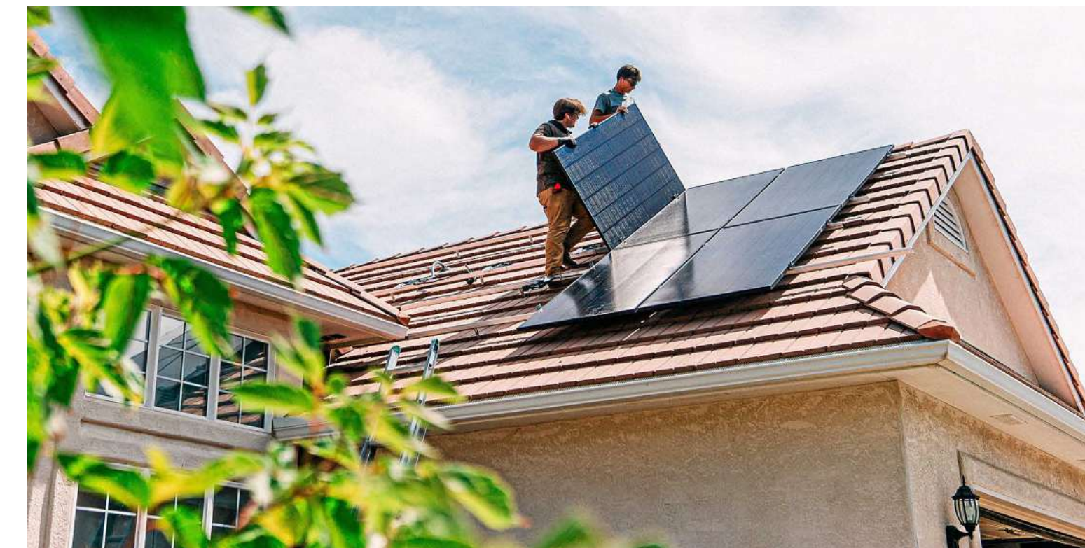
Sonnenstrom liegt im Trend – im vergangenen Jahr sind eine Million neue Photovoltaik-Anlagen in Betrieb gegangen.
