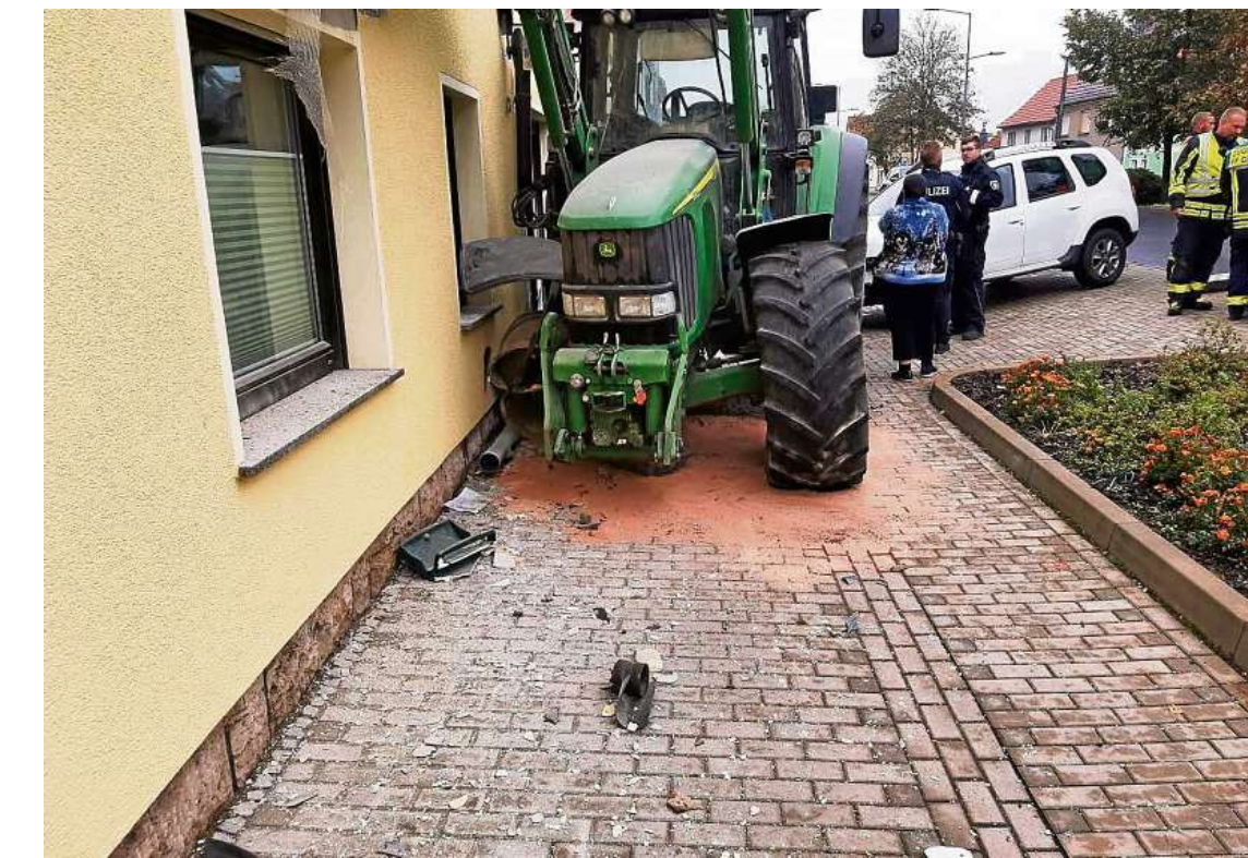
Der Traktor war im Oktober vergangenen Jahres von der Fahrbahn abgekommen. Touchiert wurden vier Häuser.
