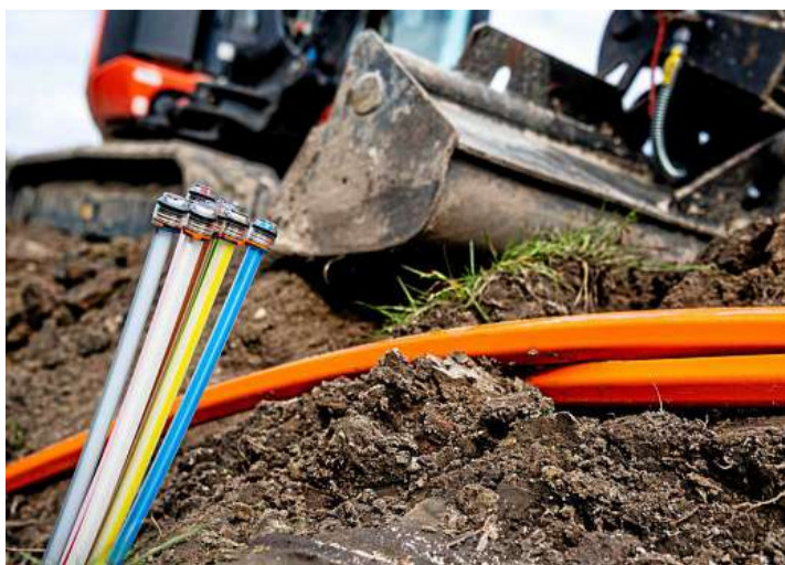
Glasfaserkabel liegen auf einer Baustelle. Doch diese Bilder sind in vielen Thüringer Gemeinde noch selten.
