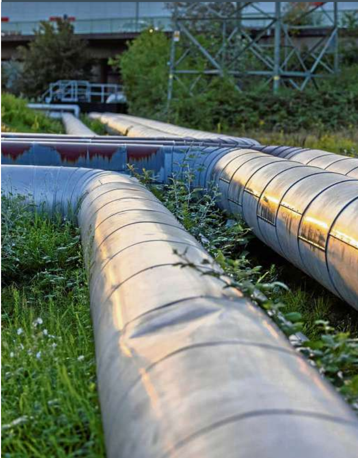
Fernwärme-Rohre laufen durch eine Grünfläche. THOMAS BANNEYER/DPA
