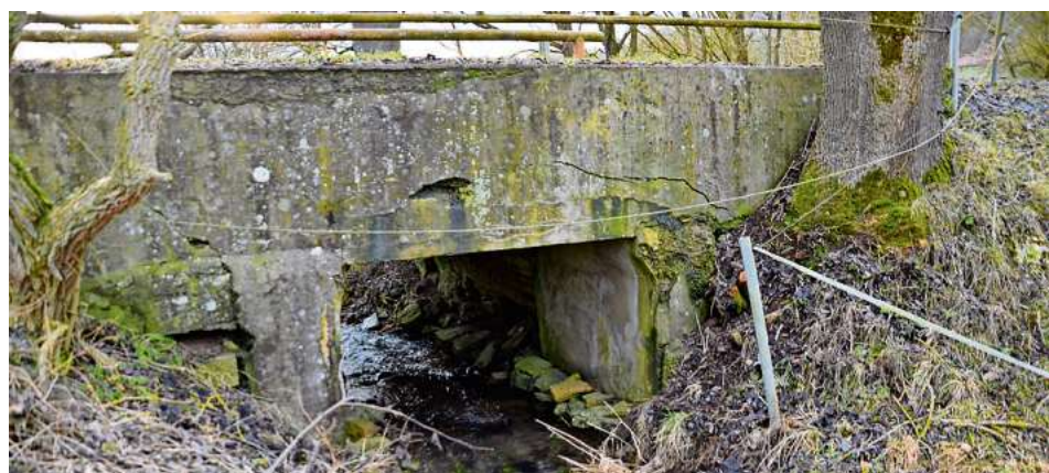
Da ist nichts mehr zu machen: Die Straßenbrücke muss ersetzt werden. Foto: Marko Hildebrand-Schönherr
